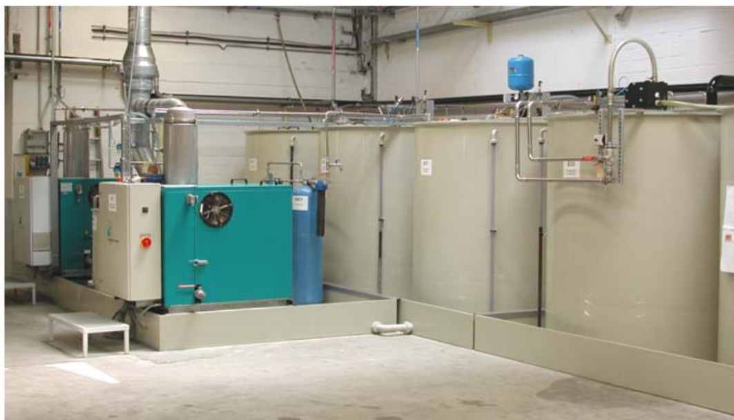
德國某公寓大樓地下室，生活污水處理系統。
